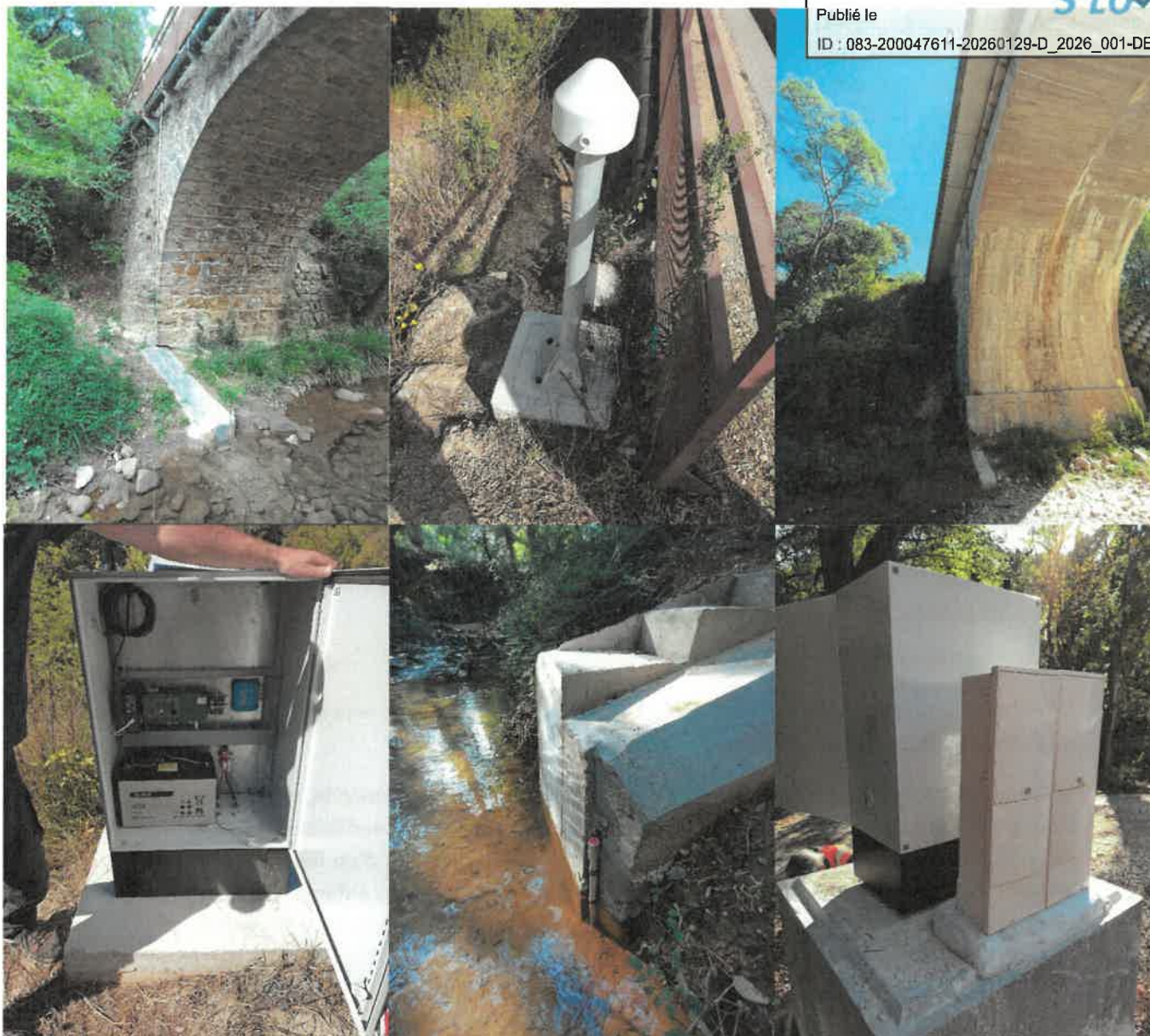
Stations de mesures et armoires de commandes des stations de la Cassole (photos 1 et 2), de la Floriène (photos 3 et 4) et du vallon de Font-Taillade (photos 5 et 6)
