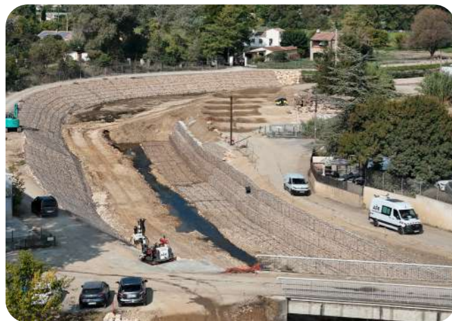
Élargissement et restauration des berges en technique minérale - marché M3 (entreprise Forézienne)
