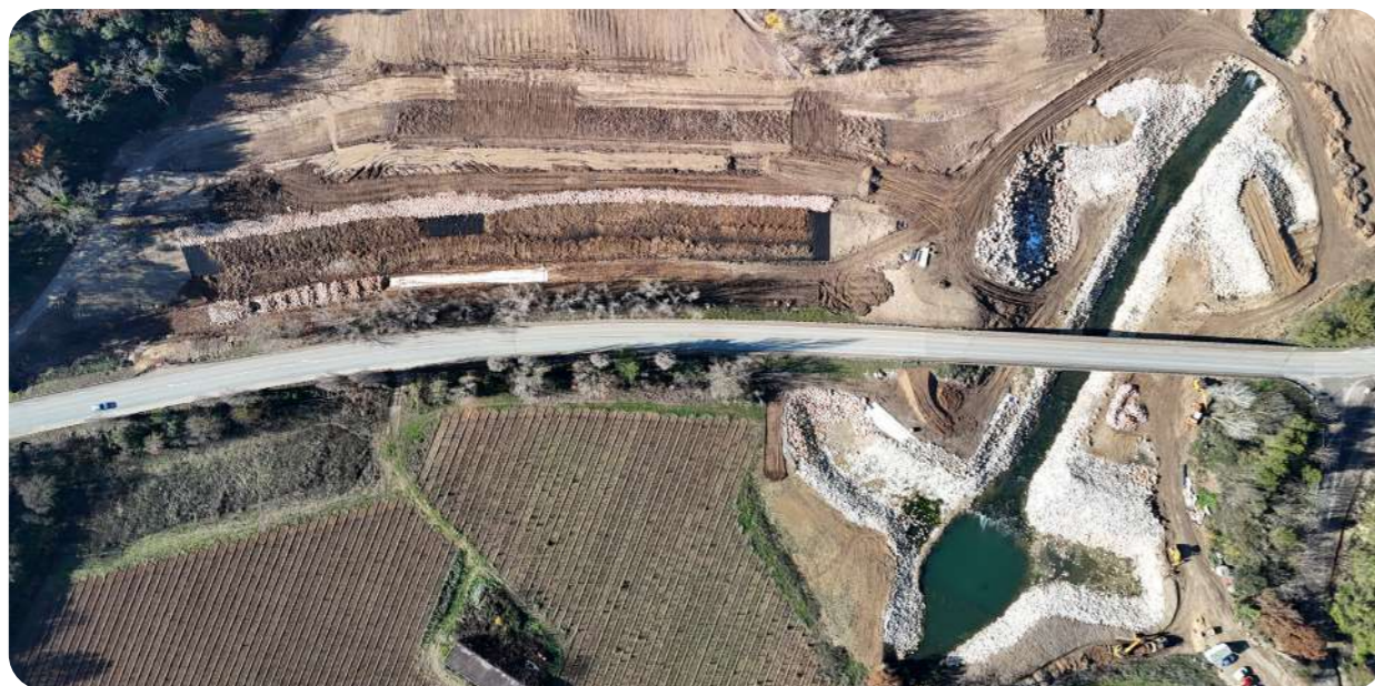
Aménagement de la mesure compensatoire hydraulique à Retru – Protection en enrochements des épis et montage du barrage - marché M3 (entreprise Forézienne)
