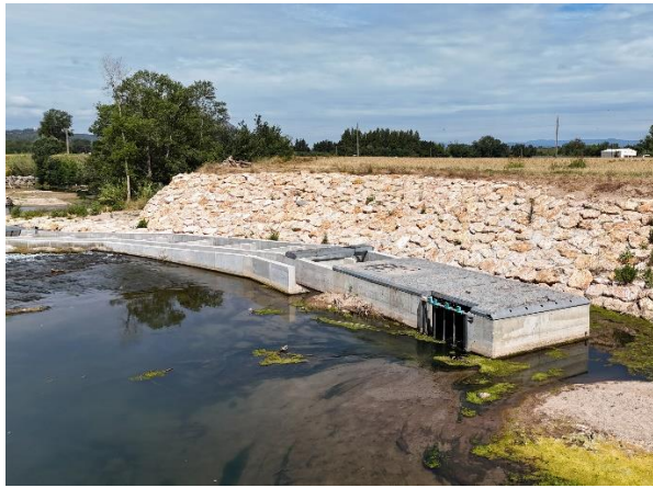
Photo 16 : Passe à poissons du seuil du Verteil à sa livraison en 2021
